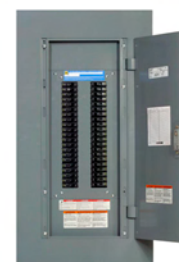
NQ 225A 42CCT MLO
